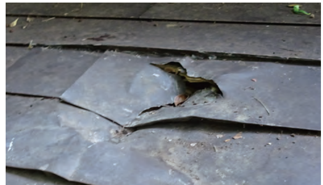
写真 45 落石による天念寺講堂屋根の被害
