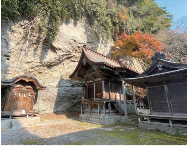
写真 31 六所神社社殿裏の岩室の状況
