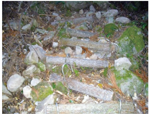
写真 48 登山道の劣化状況（登山口付近）
