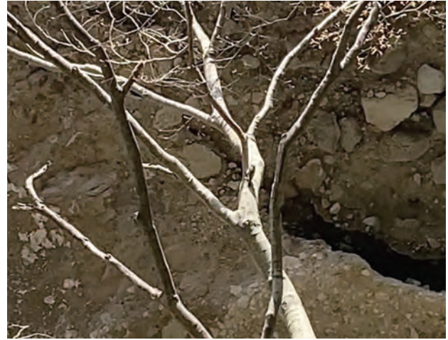
写真 32 六所神社本殿東側の岩室天井の亀裂
