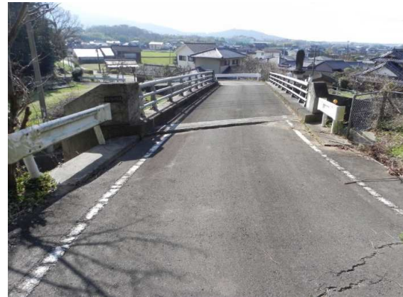
② 舗装の段差
