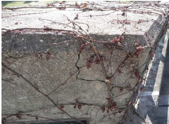
① 親柱のひびわれ
