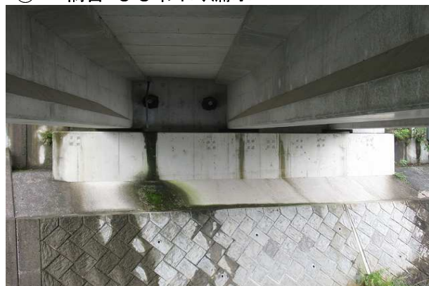
①A1橋台：ひびわれ、漏水
