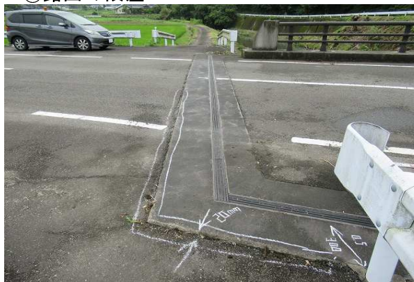
②路面の段差
