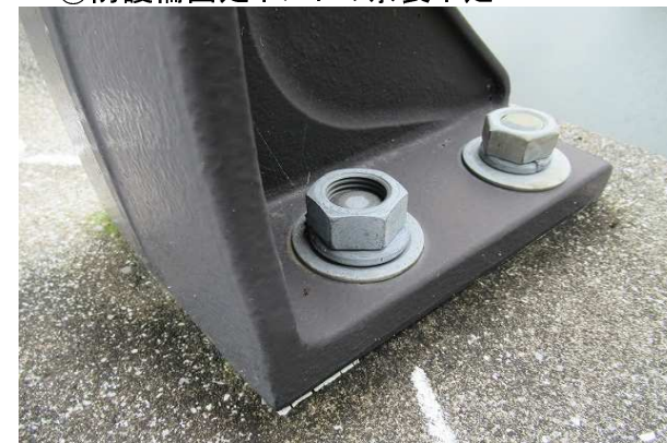
③防護柵固定ボルトの余長不足
