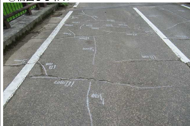
①橋面ひびわれ
