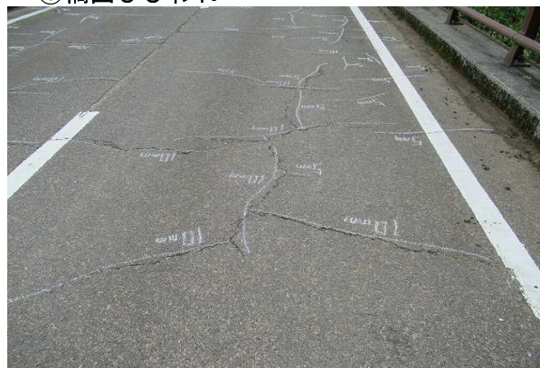
①橋面ひびわれ
