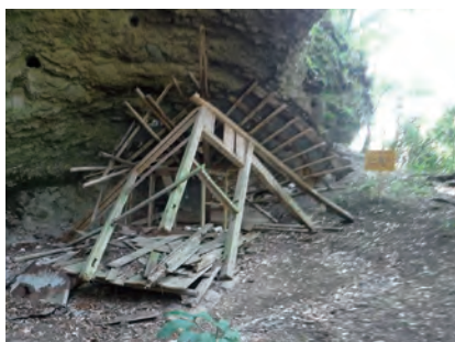
倒壊した茅場堂
