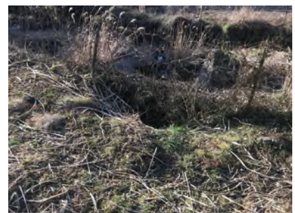
盤面が崩落した水田
