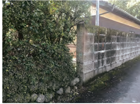
連続性を失った石垣
