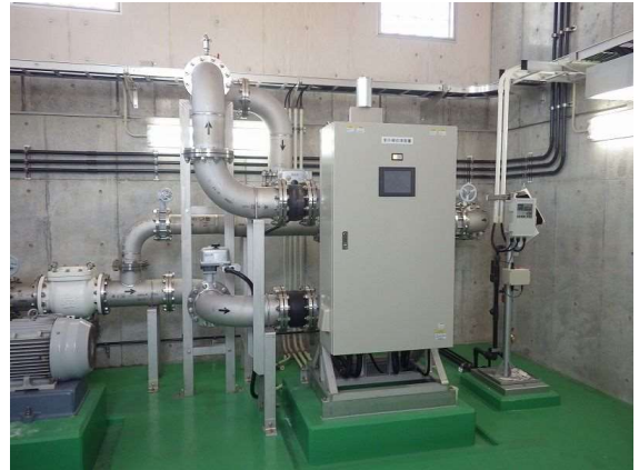
紫外線照射設備
