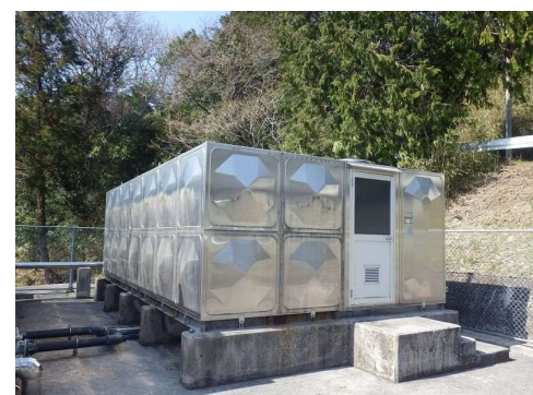
SUS製配水池
