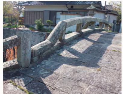
親柱から落下した衝撃で2つに折れた欄干
