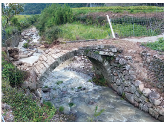
台風10号によって、左岸側の壁石が流出した戒子橋
