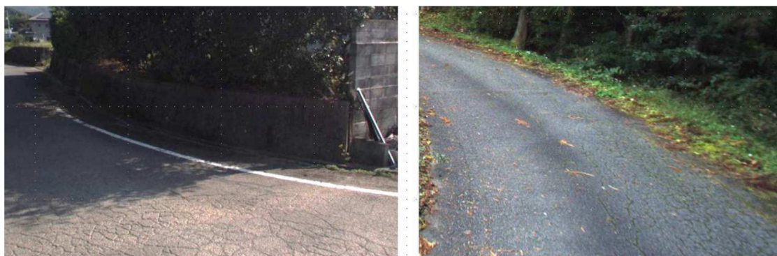
図 1-1 舗装のひび割れ（左）・わだち掘れ（右）
