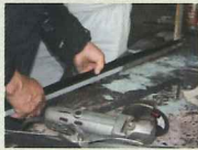
窓用ゴム 側面の引き違い窓・上げ下げ窓の取り付けに必要なゴムの多くに既製品で合うものがなく、特注
